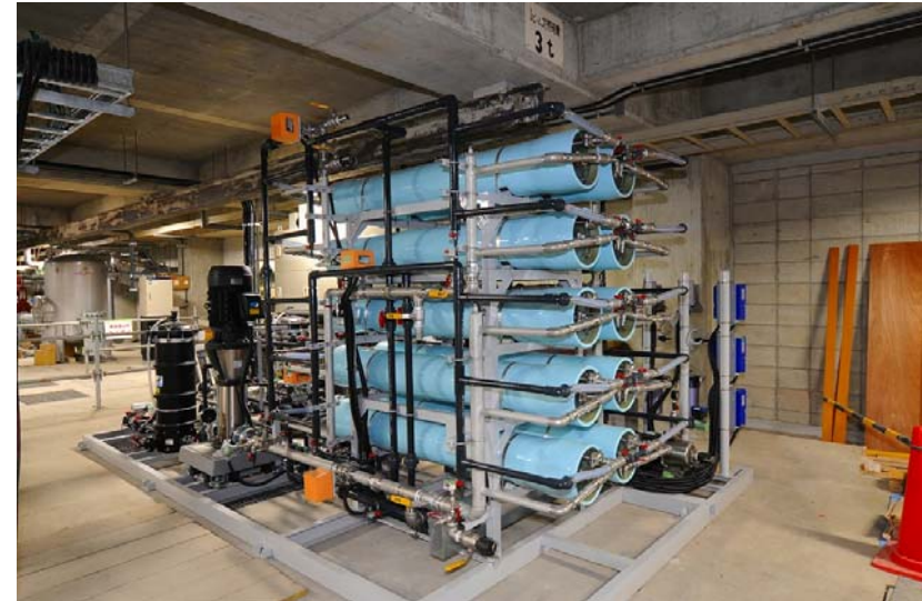
RO膜処理ユニット
