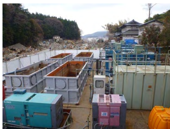
写真 I-1-48 膜分離装置（MBR）の外観
