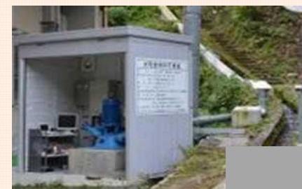
小水力発電設備
