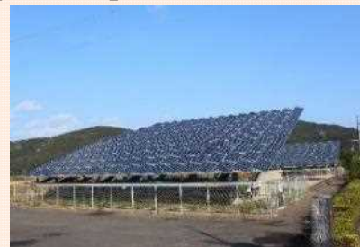
太陽光発電設備
