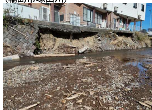
豪雨で被災した河川護岸 （輪島市塚田川）
