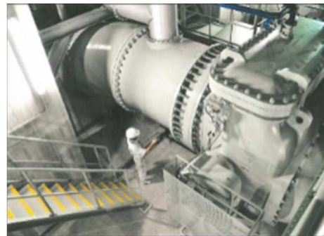
雨水ポンプの整備
