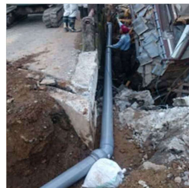
橋に仮配管懸架（露出）
