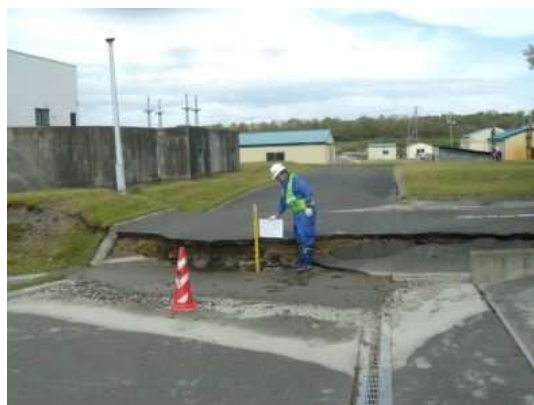
鵠川終末処理場内の地盤沈下
