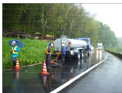
流域下水道マンホールへし尿投入
