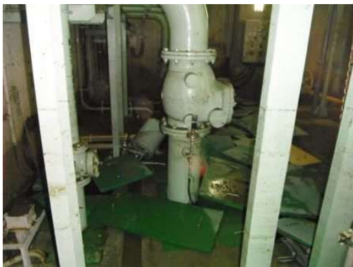
高梁浄化センター内の浸水状況
