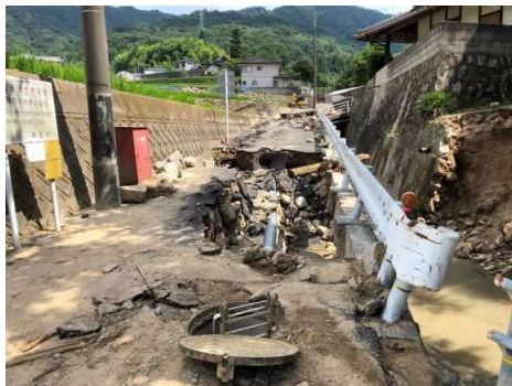
被災状況（海田町）
