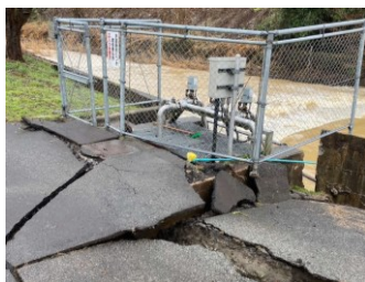
浄水場取水口の損傷
