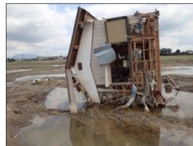
堤防決壊による家屋の倒壊
