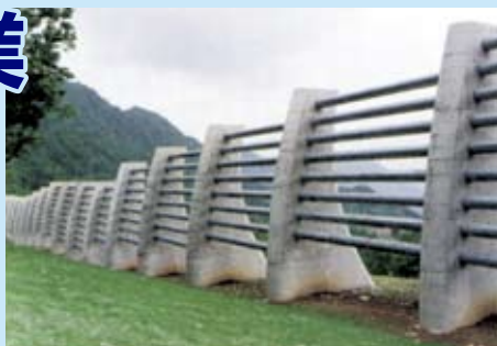
雪崩防護工 (新潟県中魚沼郡津南町)
