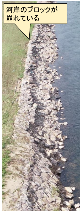
河岸の被災状況（拡大）
