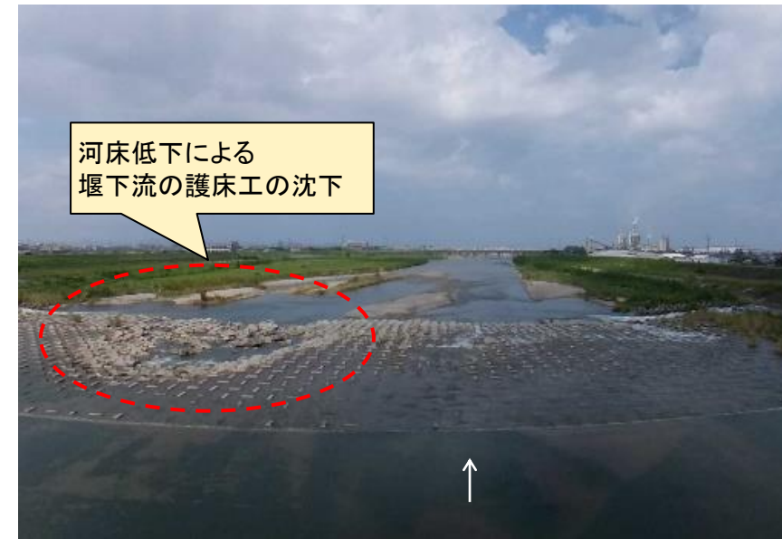
堰下流の護床工の沈下状況
