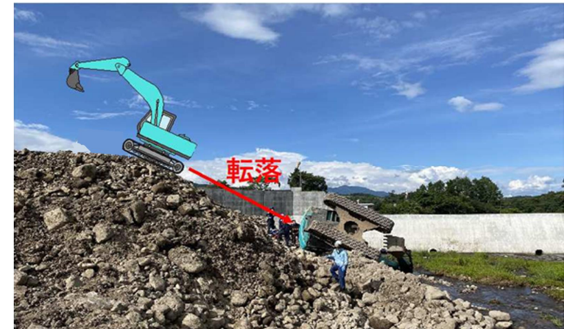
図 事故状況写真
