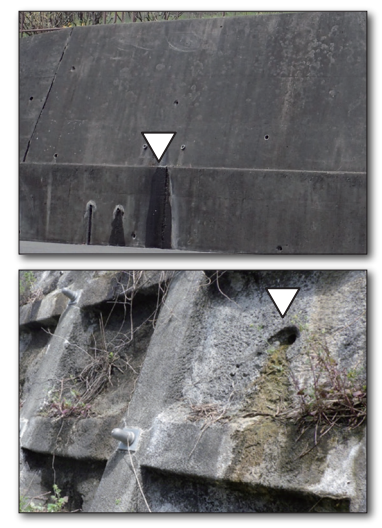
地下水の流出
